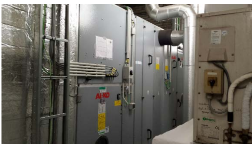
Foto: nieuwe luchtbehandelingskast centrale keuken
